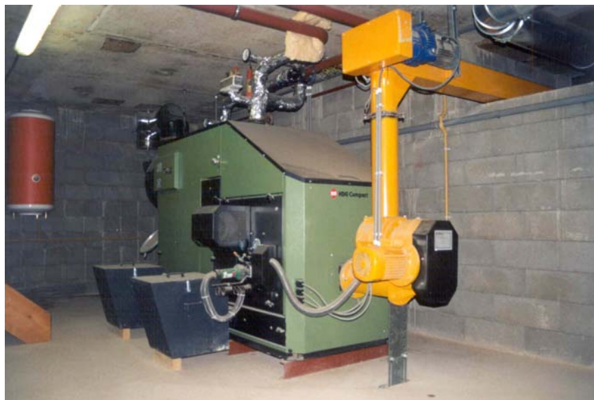
Figure : Chaudière bois dans une menuiserie (150 kW) (source : ValBiom)
